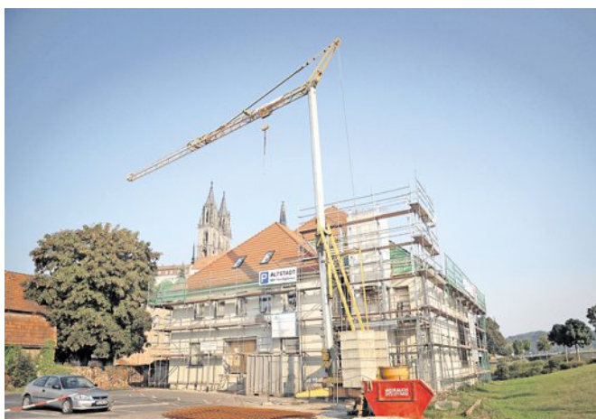
Im alten Sägewerk an der Leipziger Straße läuft der Innenausbau. Die Räume im Gebäude werden künftig auch über einen Fahrstuhl erreichbar sein. Foto: Claudia Hübschmann
